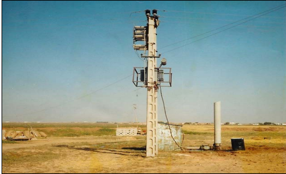
Foto 1: Harran Ovası'nda yeraltı suyundan yararlanılarak açılan bir sulama kuyusunun elektrik tesisatı ve dalgiç motorunun içinde yer aldığı kabin
