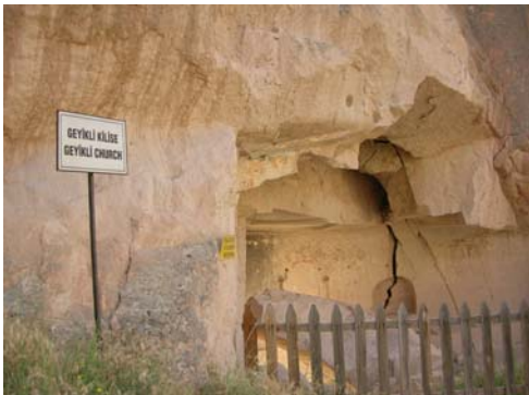
Foto 2. Zelve Vadisi’nde yıkılmakta olan Geyikli Kilise.
